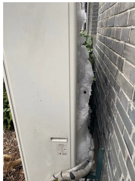
空调结冰后依然 开启导致损坏
